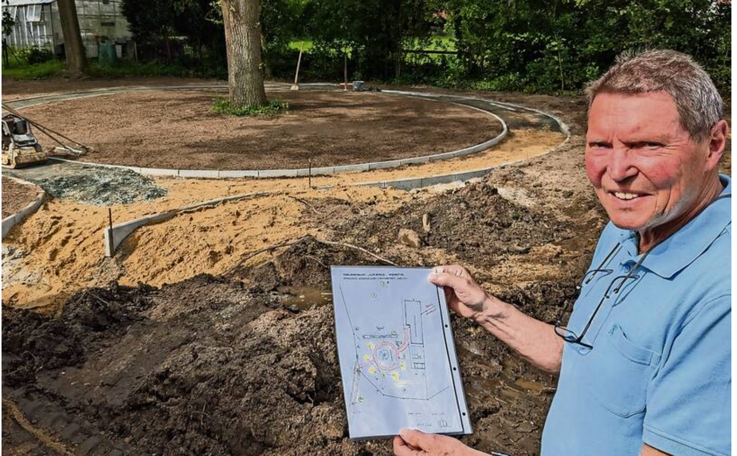
Wulsbüttels Ortsvorsteher Hannes Mahlstedt (SPD) freut sich über den Baubeginn zum zweiten Bauabschnitt des Familienspielhofes. Anhand der Pläne von 2017 wird hier ein Fitnessparcours entstehen. Palme
