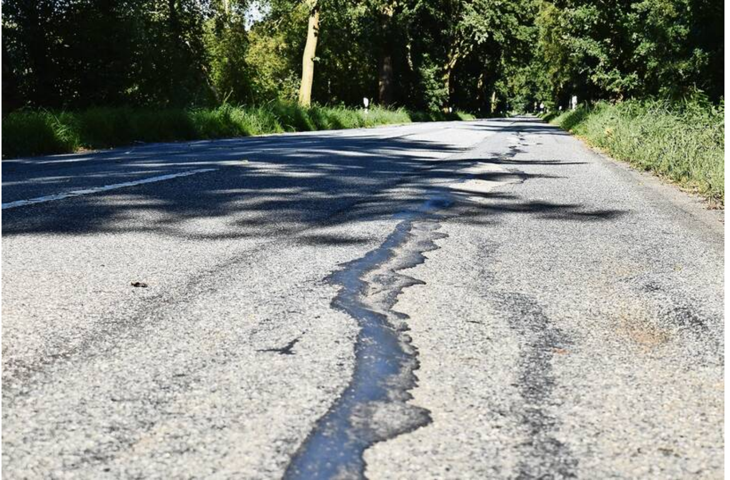
Voller Wellen und Risse: Die Kreisstraße 54 zwischen der ehemaligen B6 und Schwegen wird im November saniert. Foto: Hansen
