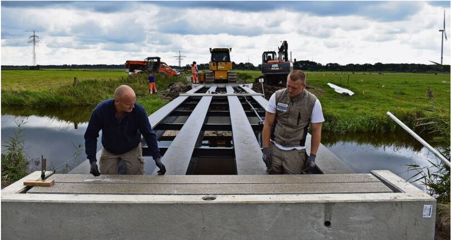
Das wird eine ganze Zeit halten: Die neue Radler-Brücke über die Alte Geeste besteht aus Stahlträgern und Kunststoffbohlen. Hansen
