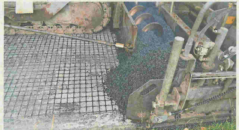
Am oberen Bildrand sind die sich drehenden Verteilerschnecken zu sehen, die den 170 Grad Celsius heißen Asphalt auf der Straße verteilen. Zu erkennen ist außerdem das sogenannte Geogitter zur Stabilisierung.
